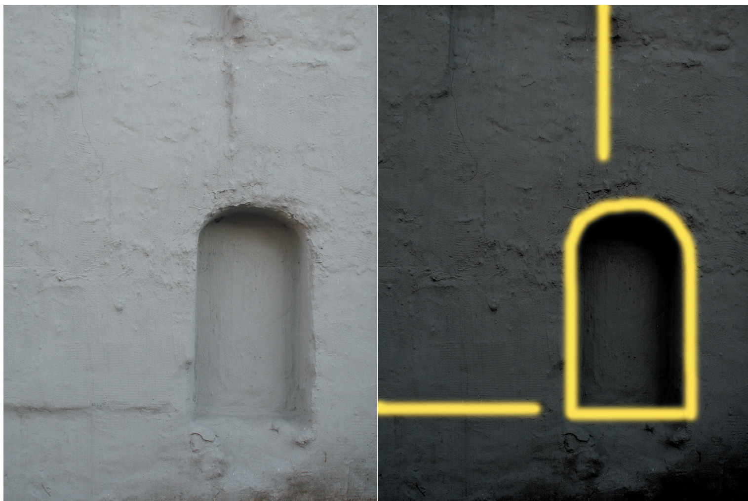
traces sur le mur de l'immeuble numero onze
